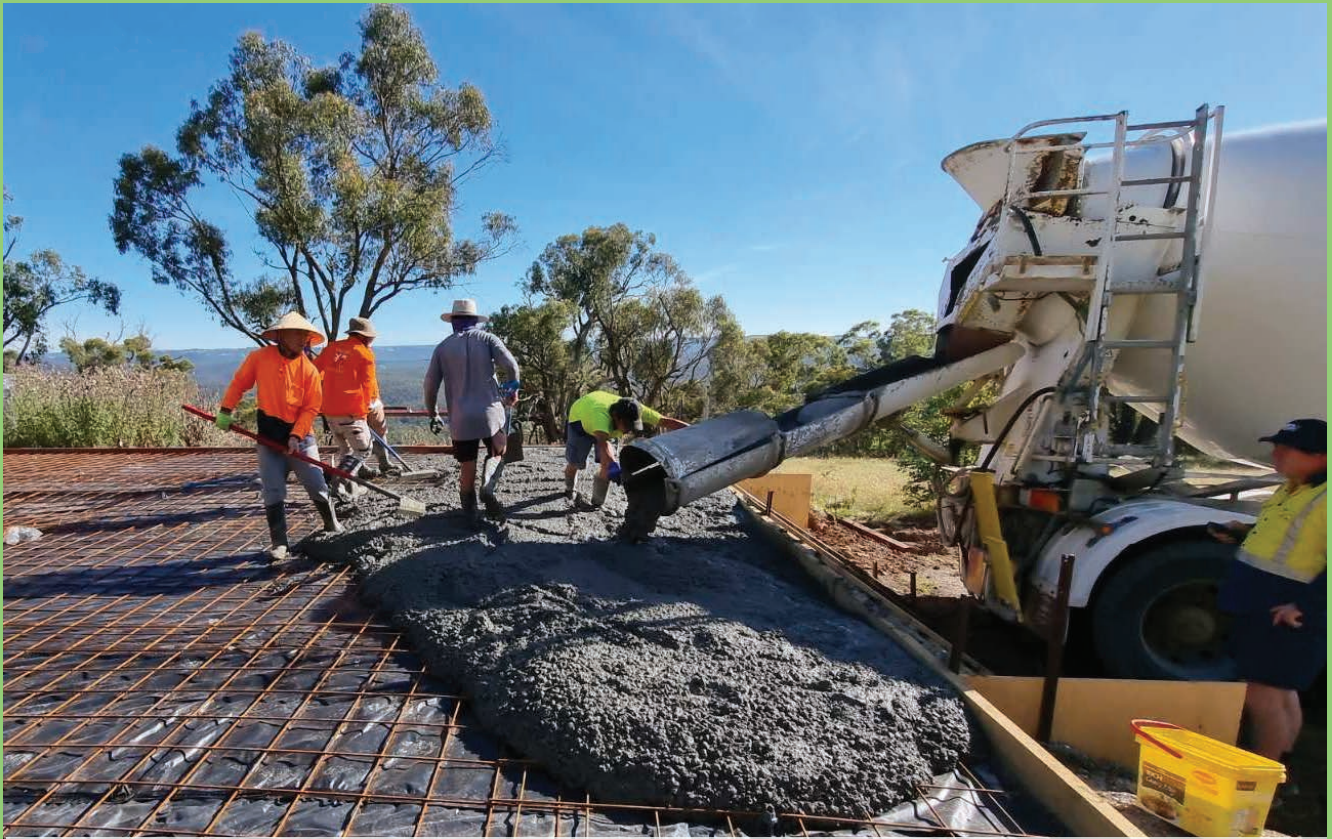
Phật tử công quả đổ concrete để xây dựng Phật Đài Quan Âm Lộ Thiên
