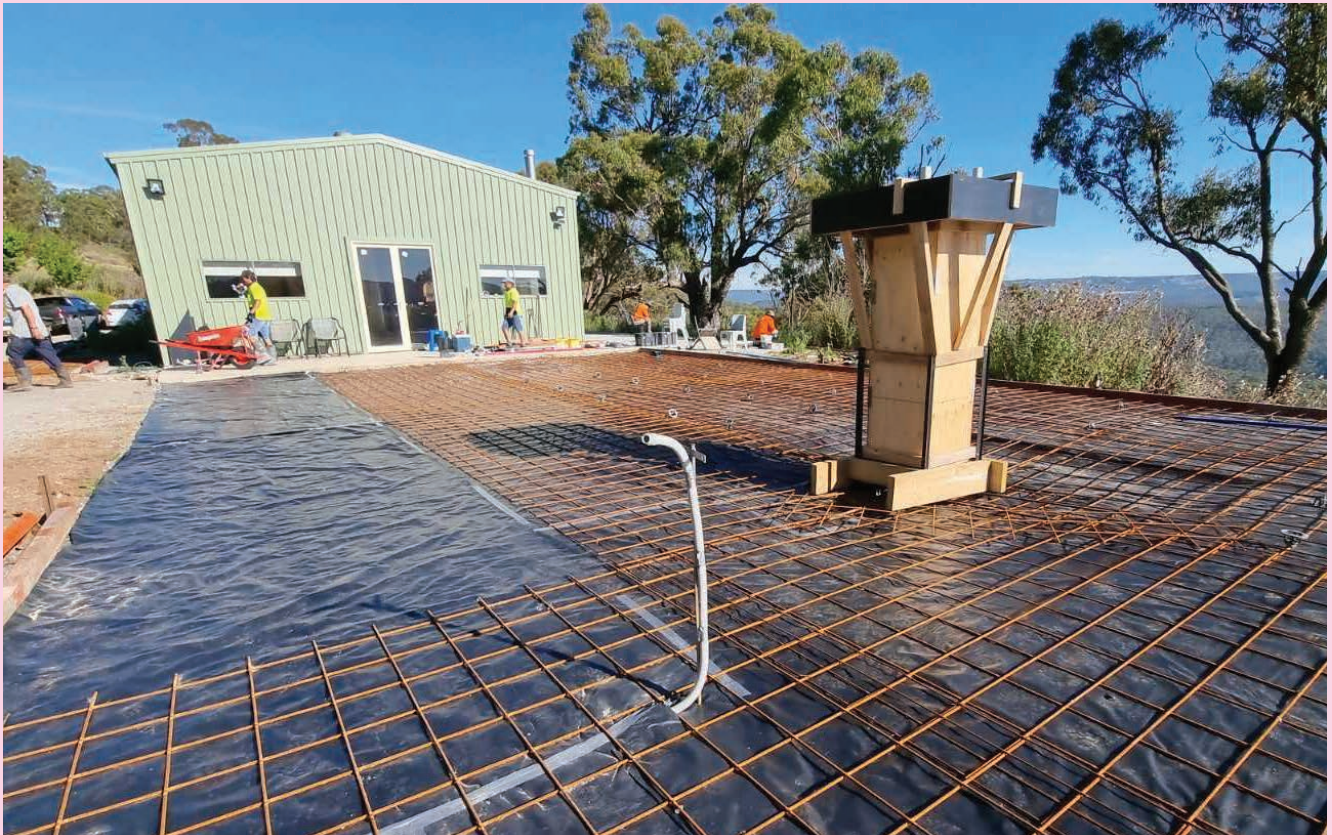
Phật tử công quả đổ concrete để xây dựng Phật Đài Quan Âm Lộ Thiên
