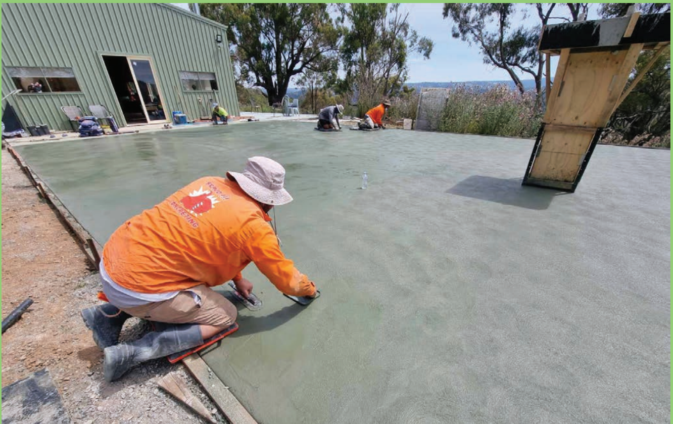
Phật tử công quả đổ concrete để xây dựng Phật Đài Quan Âm Lộ Thiên
