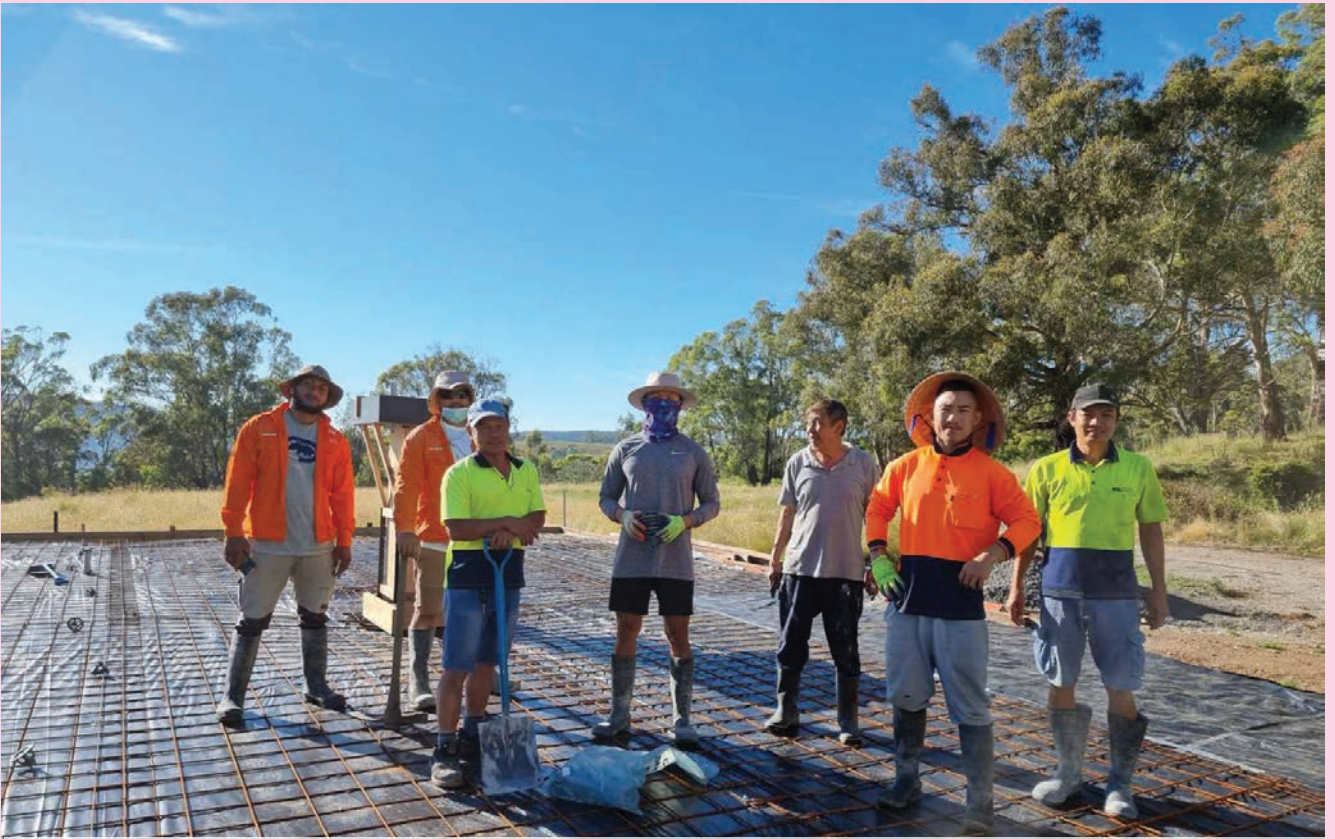
Phật tử công quả đổ concrete để xây dựng Phật Đài Quan Âm Lộ Thiên
