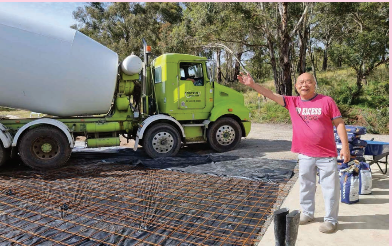
Phật tử công quả đổ concrete để xây dựng Phật Đài Quan Âm Lộ Thiên
